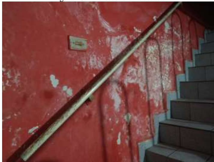
Figura 26: Eflorescência na escada.
