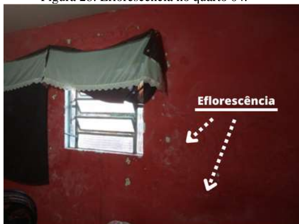
Figura 28: Eflorescência no quarto 04.
