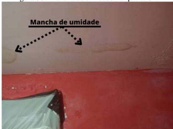
Figura 30: Mancha de umidade no quarto 04.
