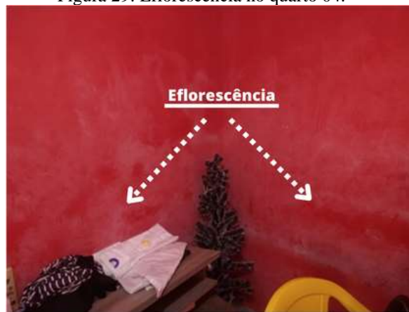
Figura 29: Eflorescência no quarto 04.
