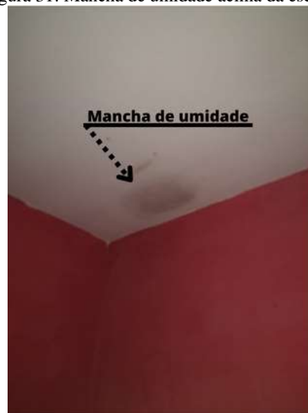
Figura 31: Mancha de umidade acima da escada.
