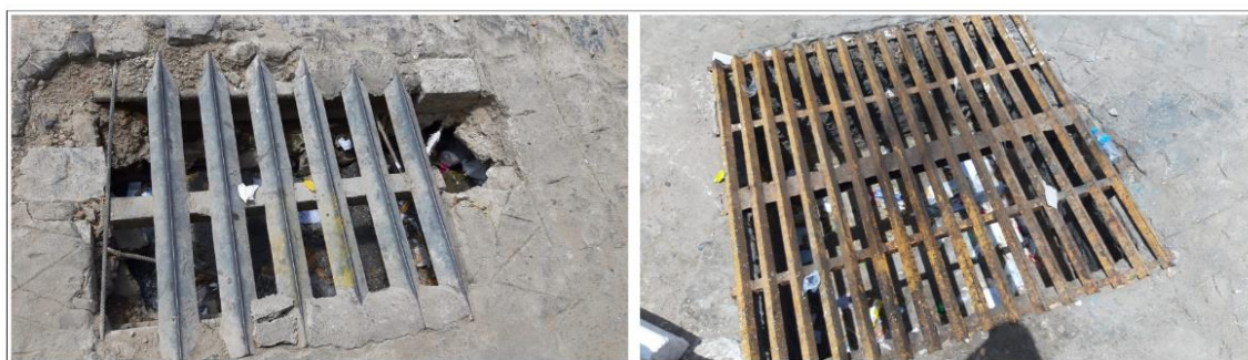
Figura 14 – Bocas de lobo com resíduos sólidos
