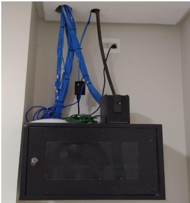
Figura 16 - Saída dos Cabos em Direção as Tomadas RJ45
