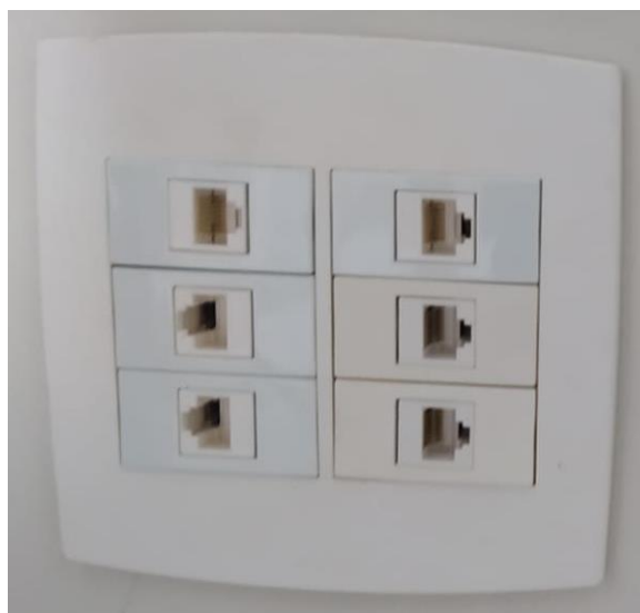
Figura 18 - Tomada 6" x 6" com Terminais RJ-45
