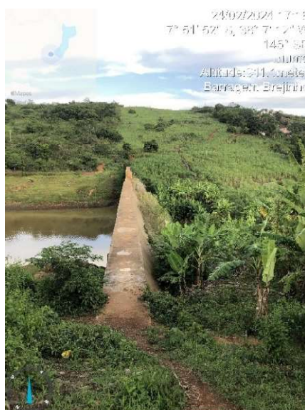
Figura 22 - Vista geral do coroamento, ausência de dispositivos de segurança na inspeção 2
