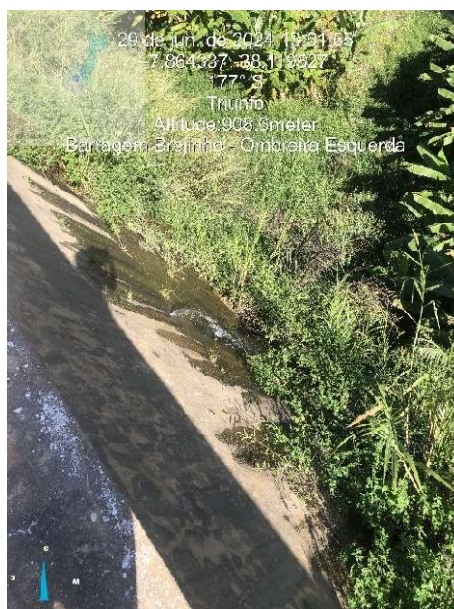
Figura 29 - Paramento de Jusante - Presença de vegetação nas falhas e fissuras existentes no barramento- Lateral esquerda - Visita 03
