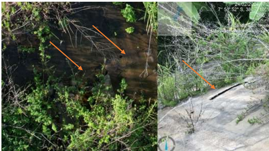
Figura 30 - Paramento de Jusante - Lateral Esquerda - Deslocamento da argamassa de revestimento - Imagem obtida com uso de drone
