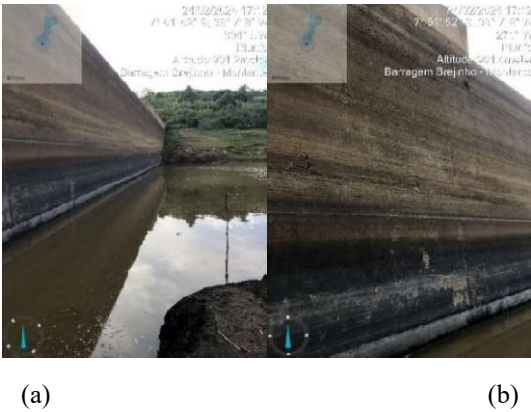
Figura 20 - Paramento de Montante - Fissuras horizontais e manchas (a) e pontos de elevada porosidade ou desagregação da argamassa (b)
