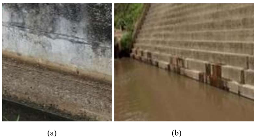
Figura 6 - Manchas escuras que representam possível porosidade do concreto (a) e infiltrações nos degraus do vertedouro da barragem (b)
