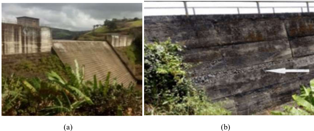
Figura 5 - Vegetação no paramento de jusante da barragem (a) e ninhos de concretagem (b)
