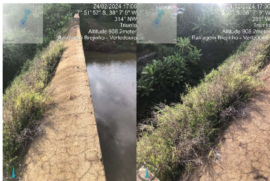
Figura 32 - Condições do sangradouro - Visita 02 - Presença de densa vegetação no barramento
