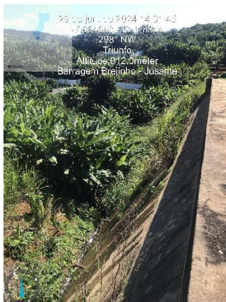
Figura 28 - Paramento de Jusante - Presença de vegetação nas falhas e fissuras existentes no barramento- Lateral direita - Visita 03
