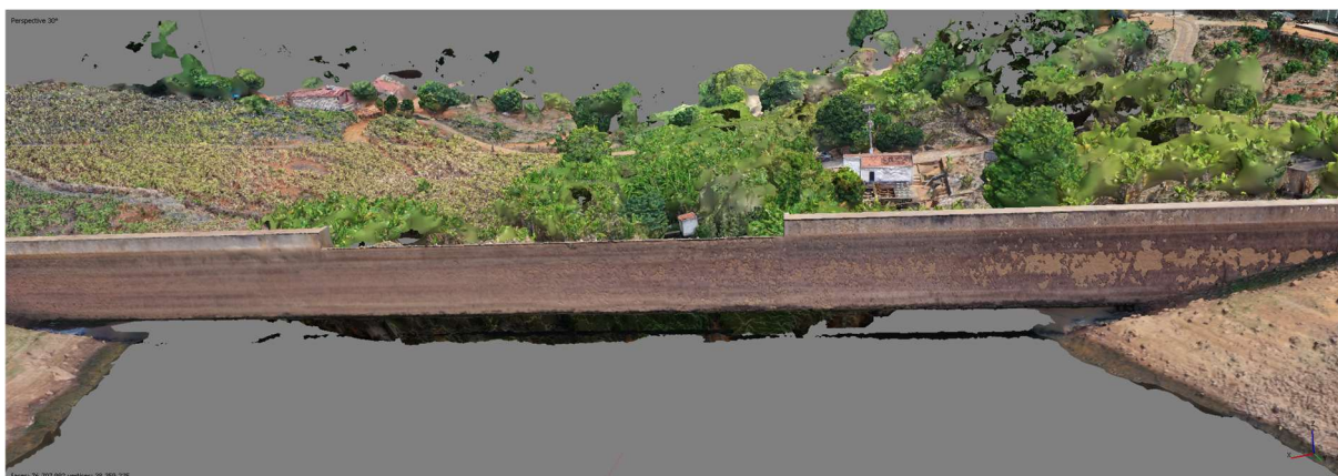
Figura 44 - Paramento de montante - Mapeamento 09/12/23
