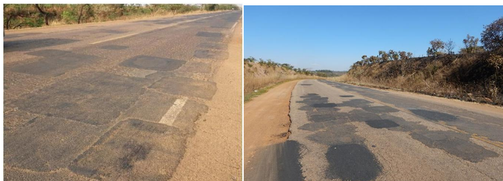
Figura 9: Defeito do tipo remendo na rodovia MG-190
