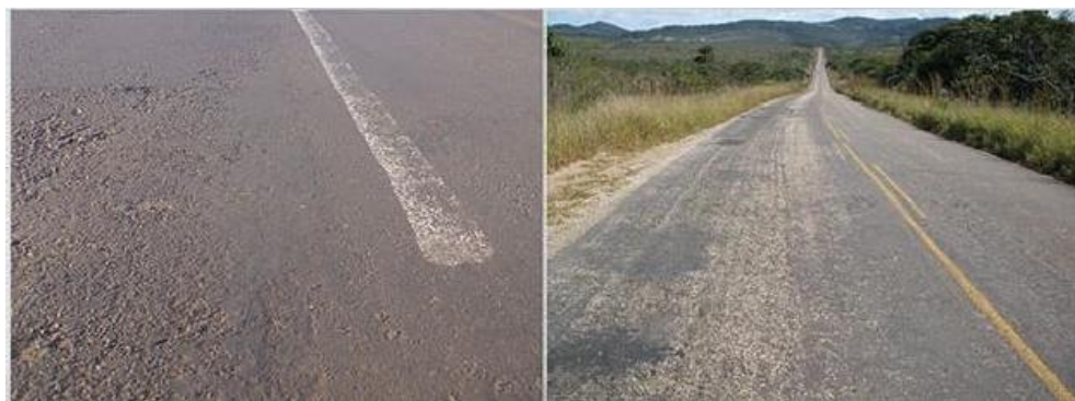
Figura 8: Exemplo de desgaste em pavimento
