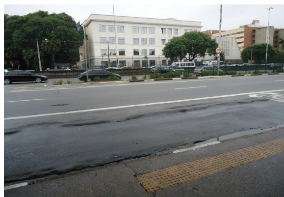
Figura 10: Processo de exsudação de asfalto na Avenida Tiradentes em São Paulo
