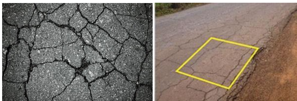
Figura 3: Trinca tipo couro de jacaré à esquerda, e à direita tipo bloco
