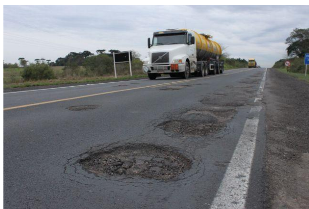
Figura 5: Buraco em rodovia gaúcha
