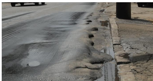
Figura 7: Ondulação no asfalto em Cariacica
