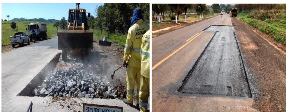
Figura 11: Remendo profundo à esquerda e superficial à direita
