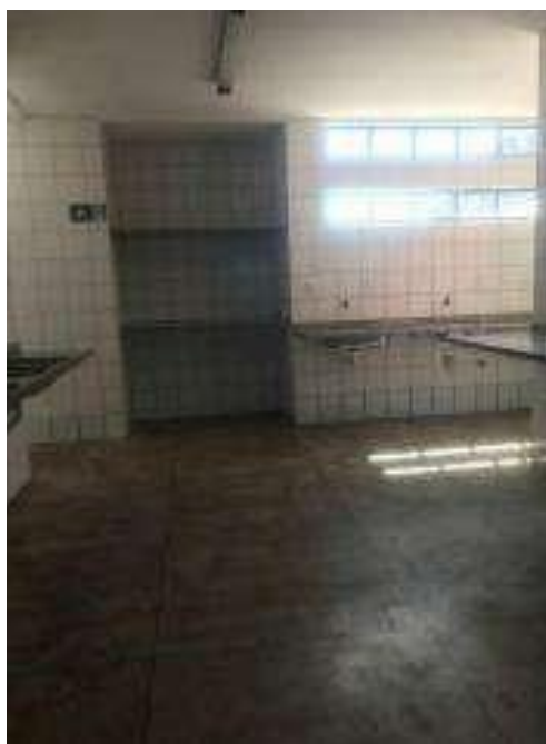
Figura 5 - Registro após a limpeza da área de produção
