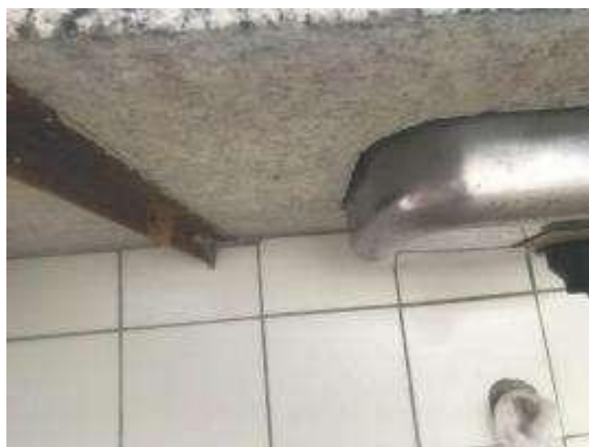
Figura 2 - Registro das condições higiênicas de uma das pias, com resíduos de ferrugem e cascas de insetos sobre os suportes e encanação aberta na área de produção
