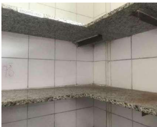
Figura 20 - Registro de ferrugem que estava sobre os suportes das bancadas onde eram colocados os alimentos secos
