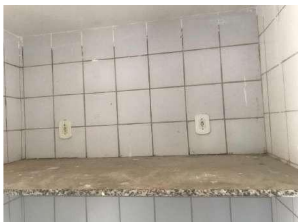
Figura 3 - Registro das condições higiênicas da bancada após uma pequena reforma que foi feita e nunca foi limpa da forma correta para armazenar as bacias
