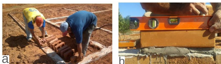
Figura 2: Primeira fiada dos tijolos sem argamassa (a) primeira fiada dos tijolos com argamassa (b)
