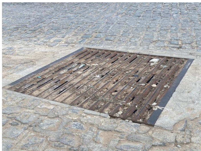
Figura 18 – Única boca de lobo da Avenida Custódio Conrado
